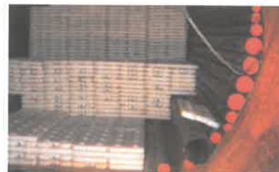
Immagine 22 - Interno di cisterna interrata per accumuli crioscopici.
